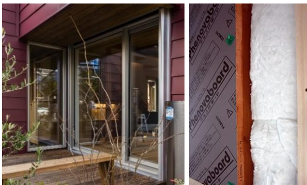
最も熱が逃げやすい「窓」にはトリプルガラスの樹脂窓を設置し、壁・屋根には二重に断熱材を設置
