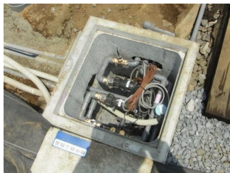
地中熱交換器と横引き配管の接続部
