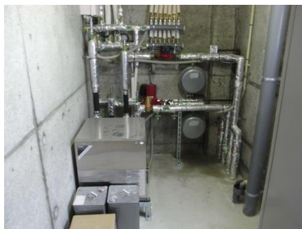
ヒートポンプ
