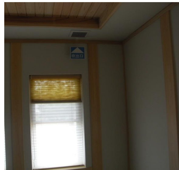
居室の吹出し口
