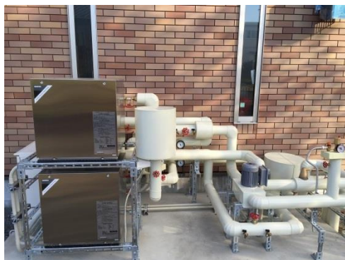
ヒートポンプ(熱源機)
