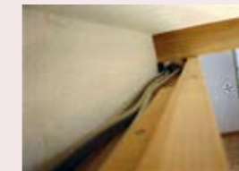
長押の高さに設けた木製の配線ボックスの例
