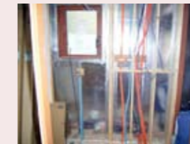
洗面化粧台の背面を利用して垂直方向に配管スペースを確保する例
