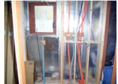
洗面化粧台の背面を利用して垂直方向に配管スペースを確保する例
