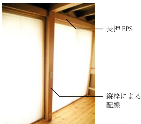
長押 EPS と縦枠配線
