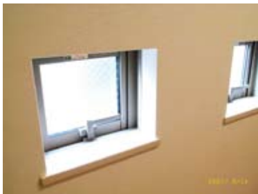
例4. 窓枠のない窓
