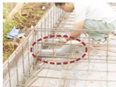
図3：さや管により将来排水管を交換できる準備をしている例
