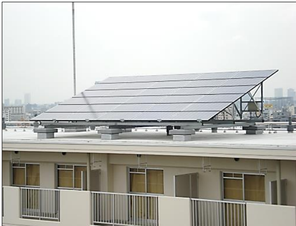
太陽光パネル
