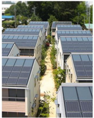
南面の屋根にある発電・集熱パネル
