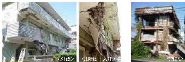
2階の廊下部分が崩落した事例
